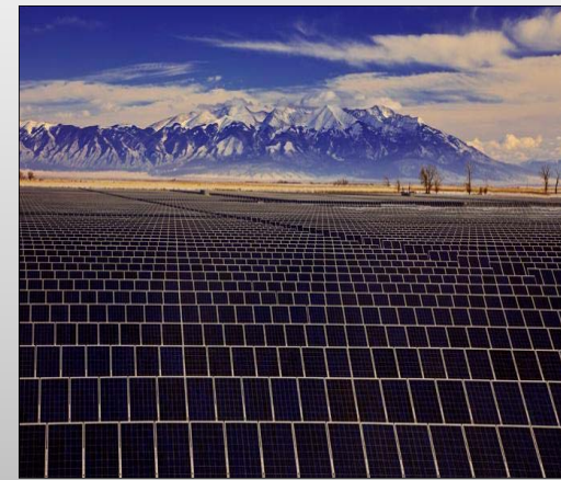
Colorado, USA – 8 MW
